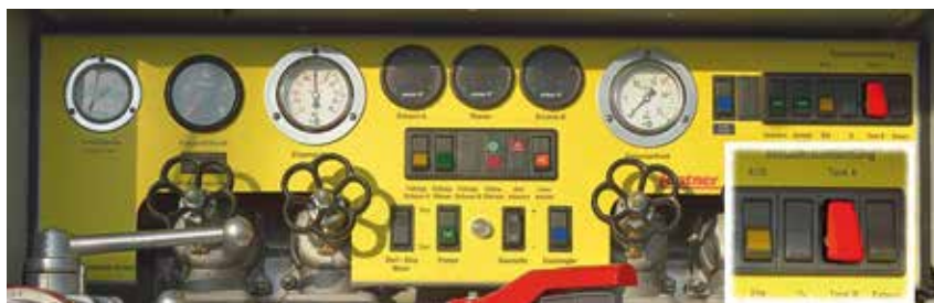
Pumpenbedienstand mit eingebundener Druckzumisanlage. Das Fahrzeug verfügt über zwei Schaumtanks (Tank 1, Tank 2). Ein Umschalten auf Tank 2 ist mittels Bedienung des Sicherheitsschalters (gesichert mit roter Kappe) möglich.
